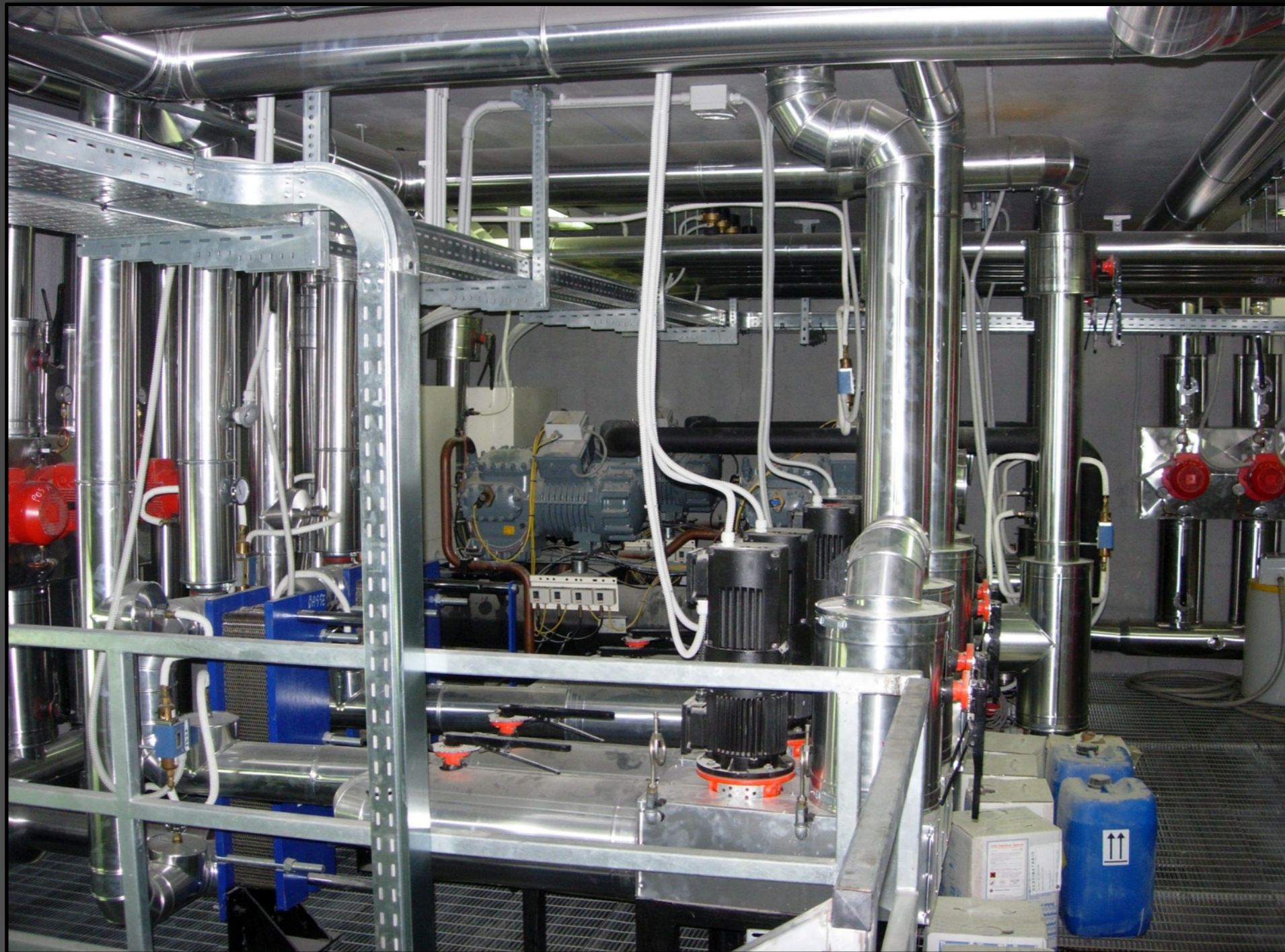
Pompe di calore produzione acqua calda sanitaria
