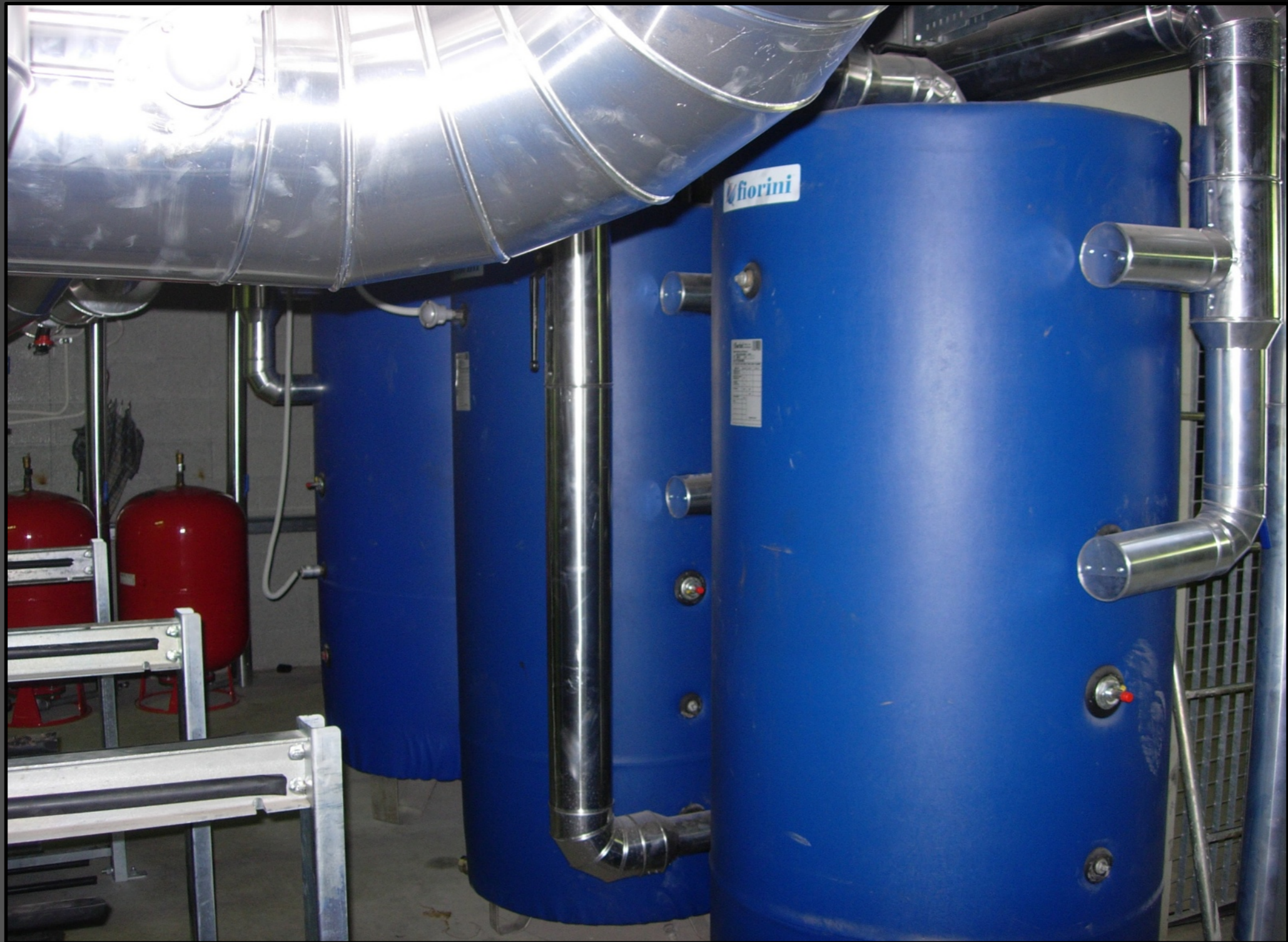
Serbatoi accumulo acqua calda sanitaria
