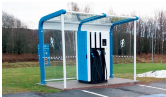
Stazioni ricarica veicoli elettrici FAST DC
